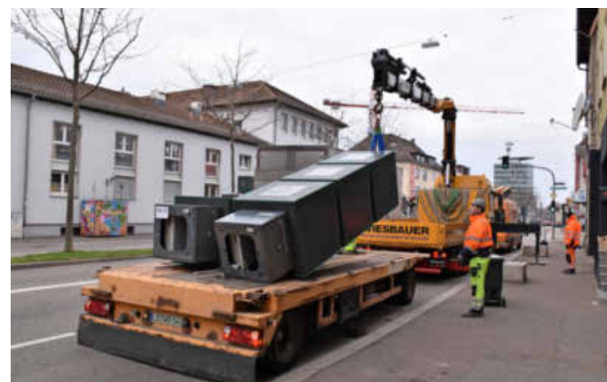
Dank der Verbesserung der Luftqualität haben die Luftfiltersäulen in der Weinsberger Straße ausgedient. Foto: Küpper
