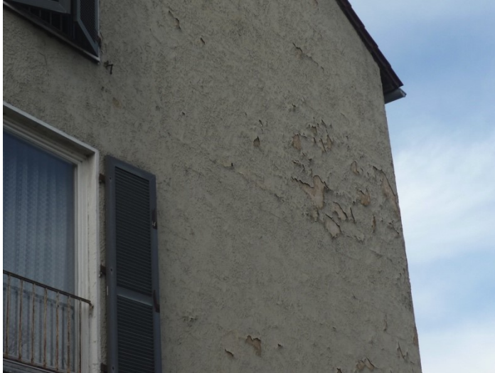
Abb. 11: Alte Fenster, Mängel in Fassade
